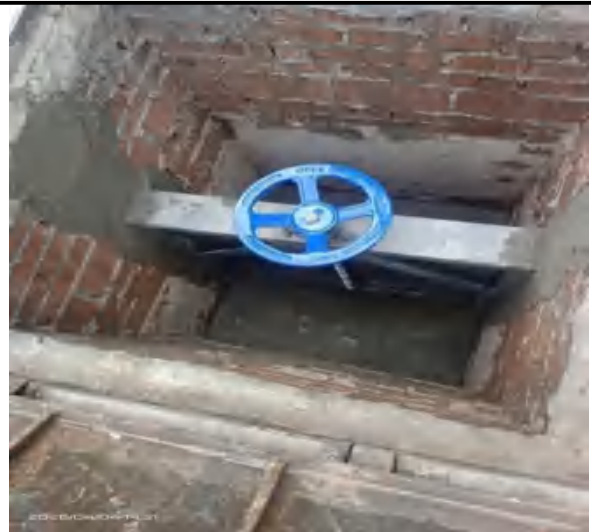
雨水排放口应急阀门
