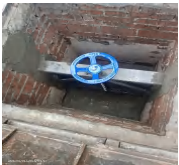
雨水排放口应急闸门
