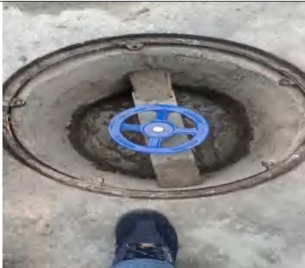
事故应急池闸门
