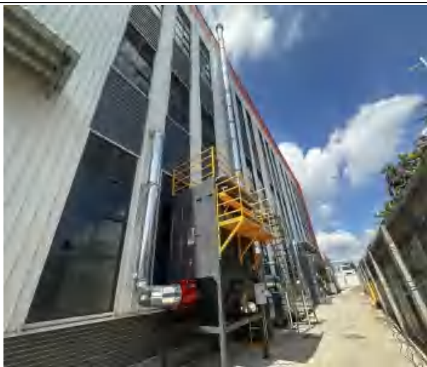
布袋除尘器装置
