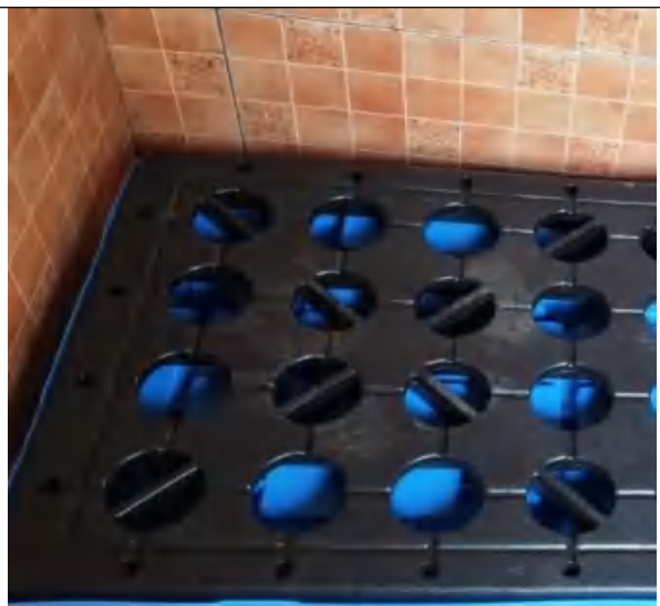
危险废物暂存间托盘
