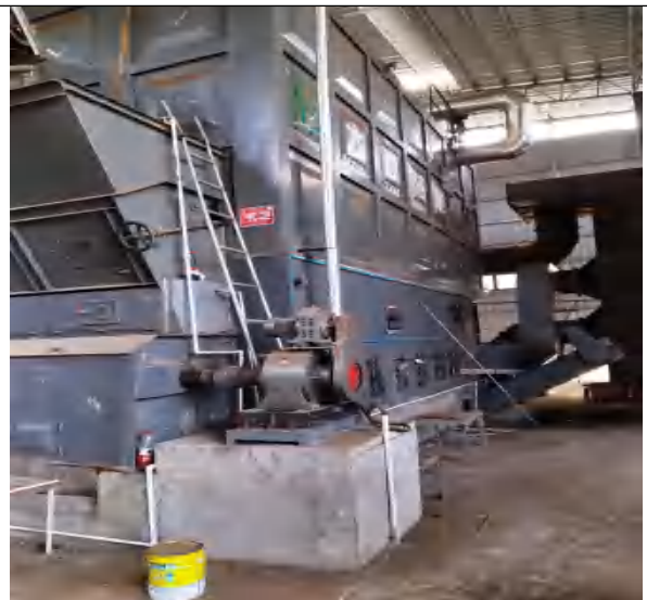
废气治理设施
