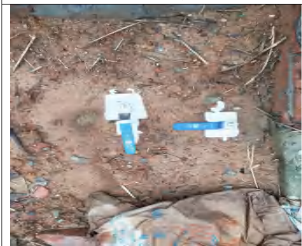
应急池、雨水闸门
