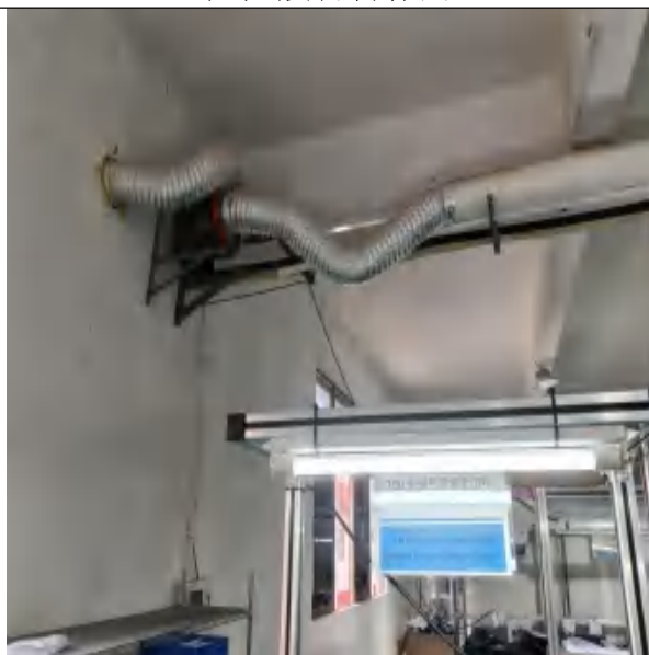
废气处理装置
