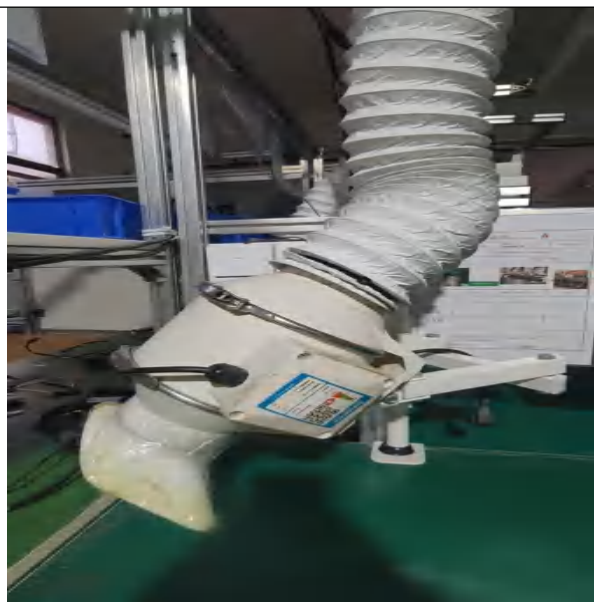
废气收集装置
