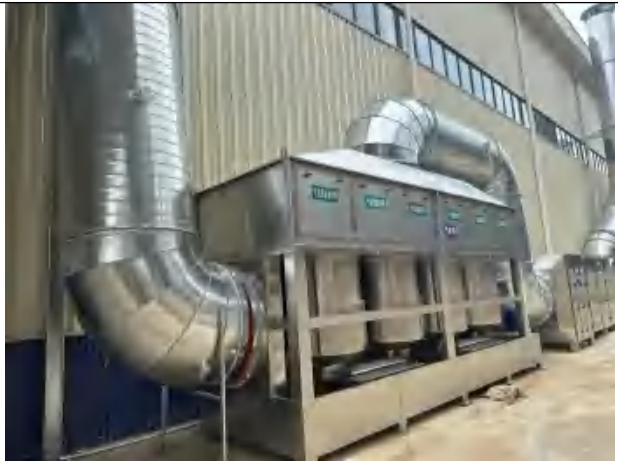
废气治理设施
