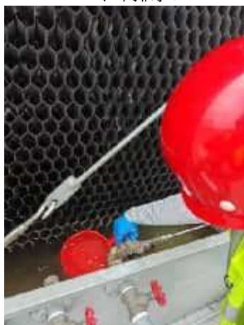
W1 冷却排水口
