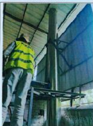
DA001 燃烧废气排放口
