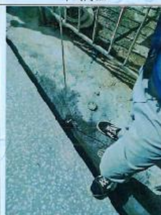
W1 生活污水排放口
