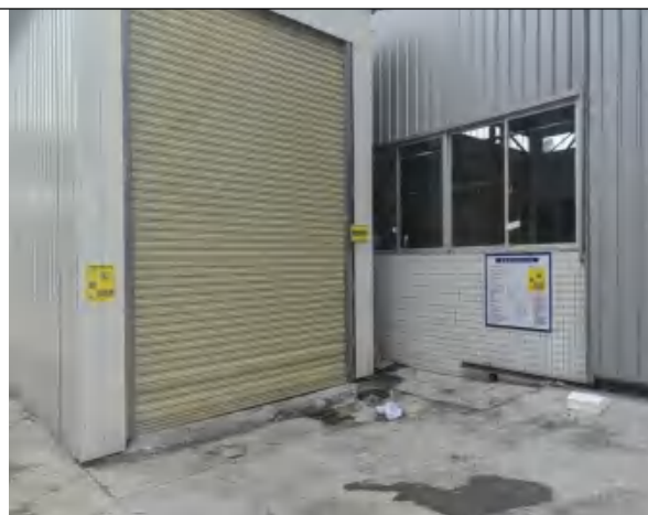
危险废物暂存间
