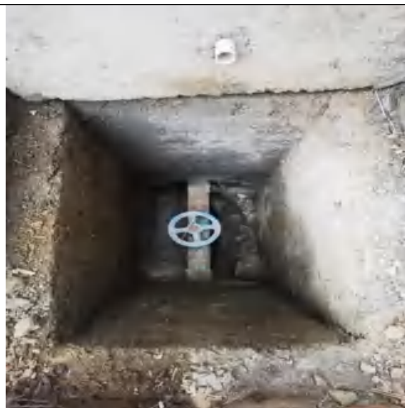
枫树化工厂雨水排放口应急阀门
