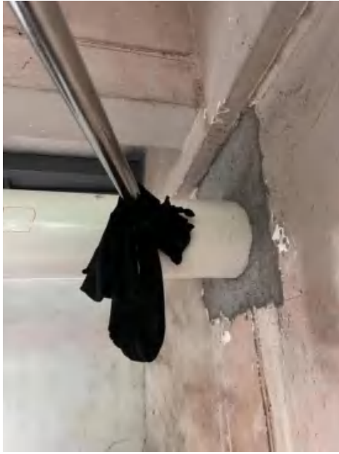
厨房油烟处理前检测口
