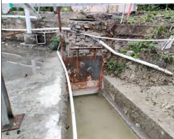
雨水排放口应急闸门
