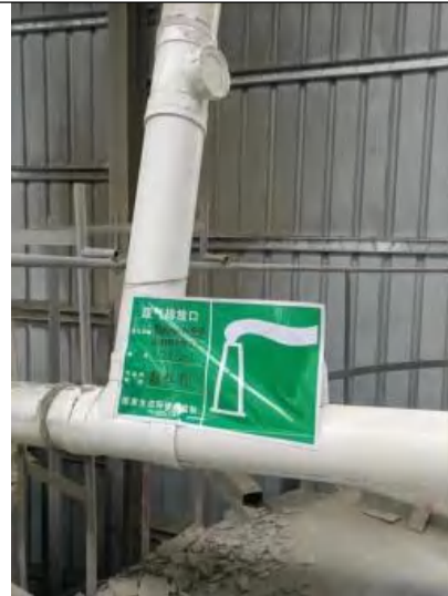
废气排放口及标识
