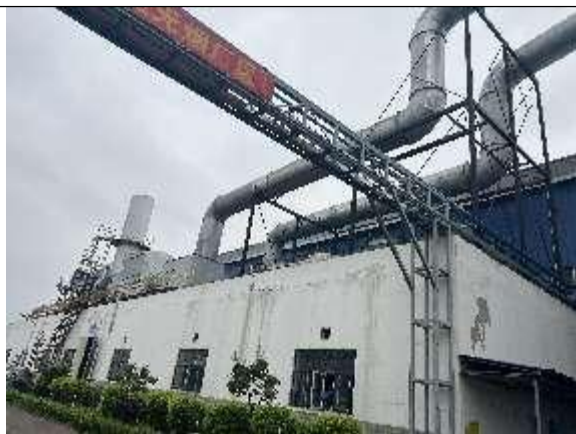
水喷淋+高效过滤器+沸石转轮+RTO
