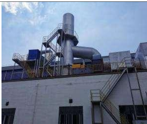
水喷淋+高效过滤器+沸石转轮+RTO
