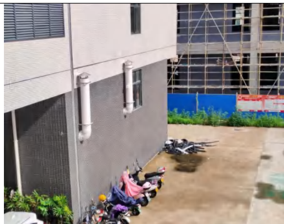
厨房油烟排放口
