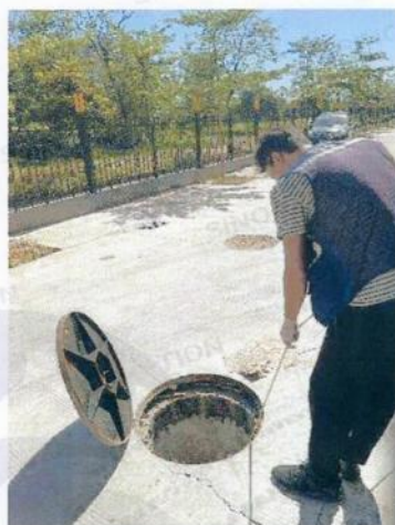
生活污水排放口
