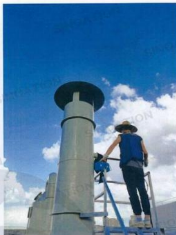
DA002 废气排放口
