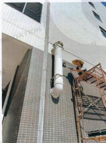
DA003 厨房油烟排放口
