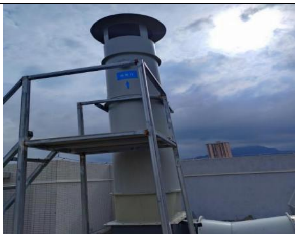
有机废气排放口
