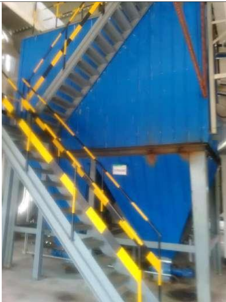
废气焚烧炉的布袋除尘器
