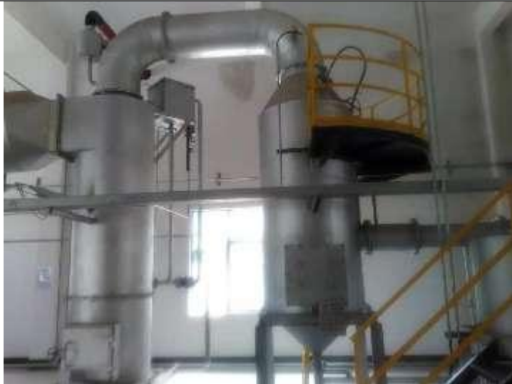
固废焚烧炉的 SNCR 脱硝
