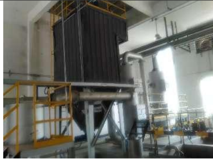
固废焚烧炉的布袋除尘+碱液喷淋
