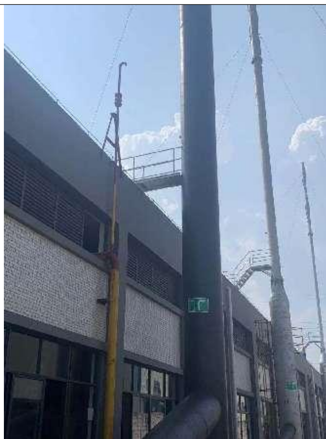
锅炉废气排放口检测平台及排放口标识
