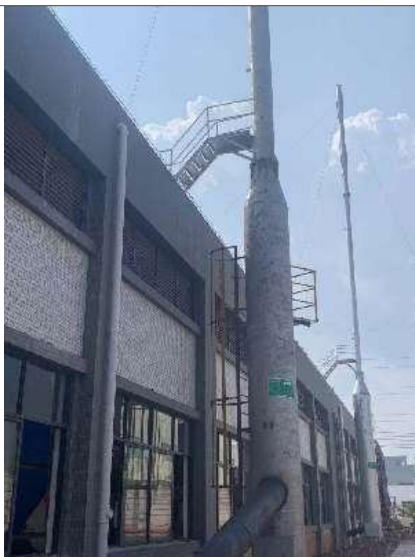
有机废气焚烧炉排放口检测平台及排放口标识
