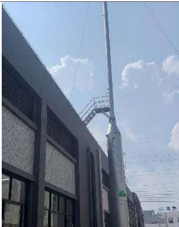
固废焚烧炉排放口检测平台及排放口标识
