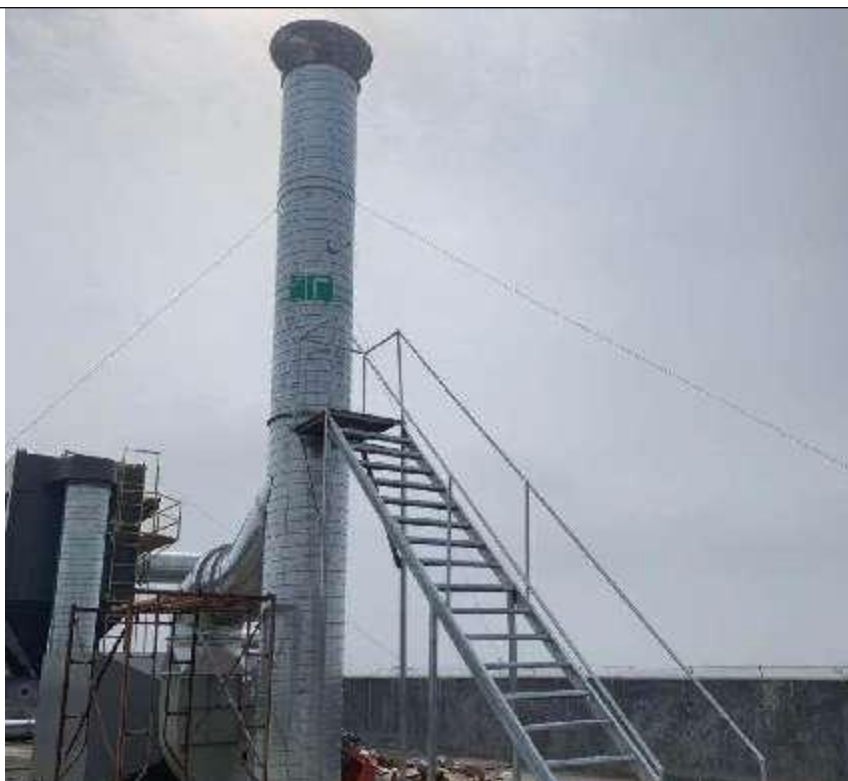
粉尘废气排气筒检测平台及排放口标识
