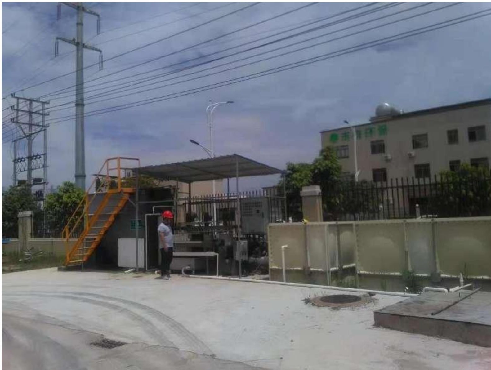
废水治理设施:
