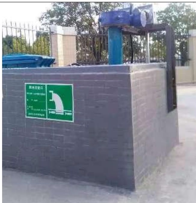
初期雨水排放口
