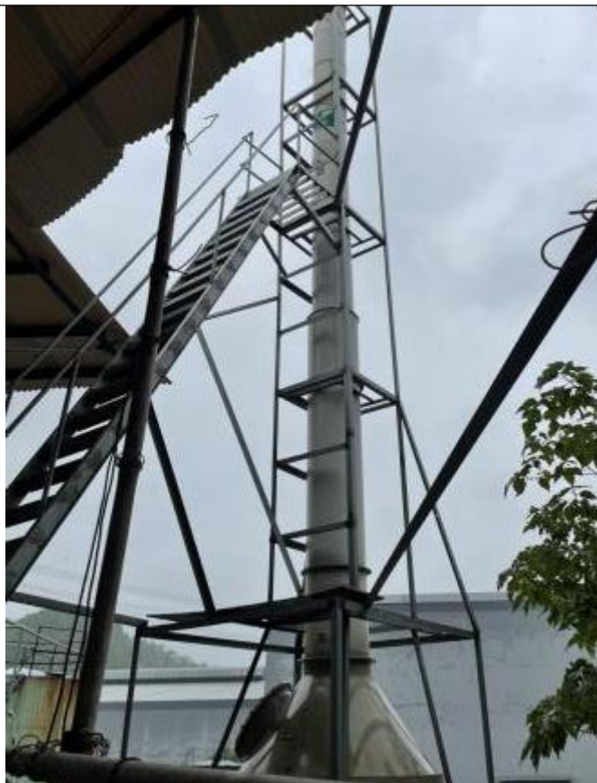
DA002（硝酸罐区排放口）
