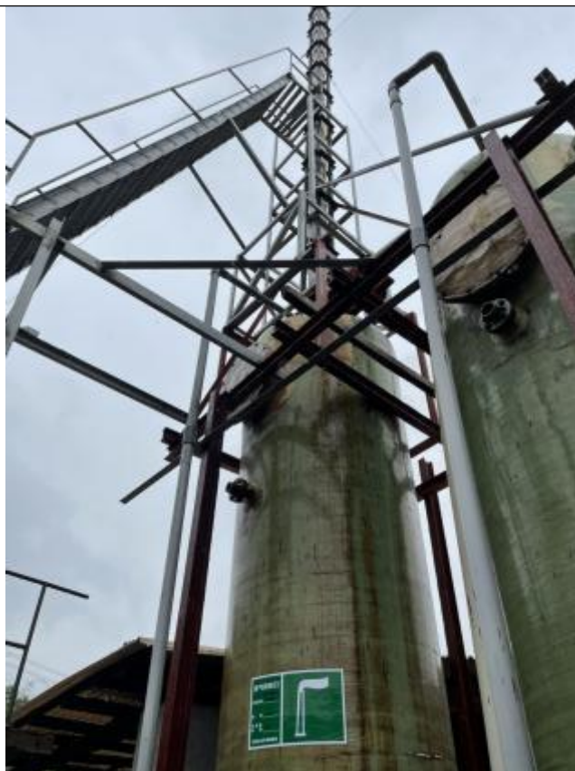
DA001（盐酸罐区排放口）
