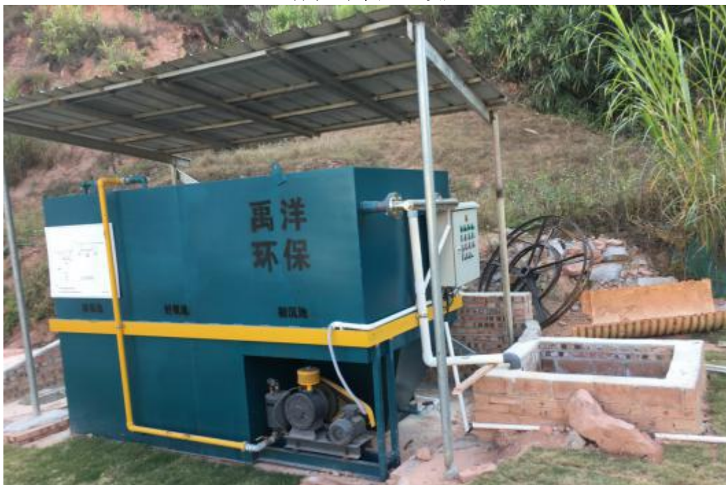
一体化污水处理设施
