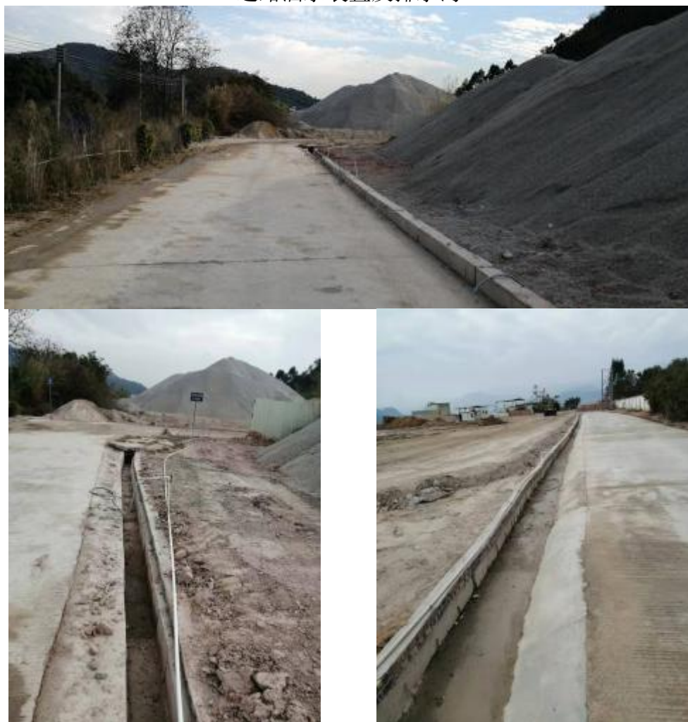
道路洒水装置及排水沟
